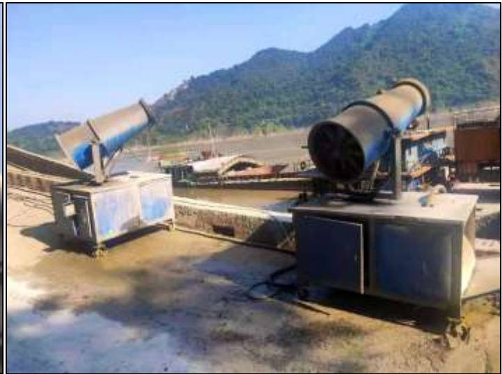
码头洒水抑尘设备
