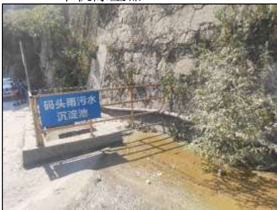
码头雨污水沉淀池
